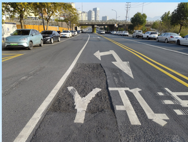
▲育才小学岔路口路面破损
